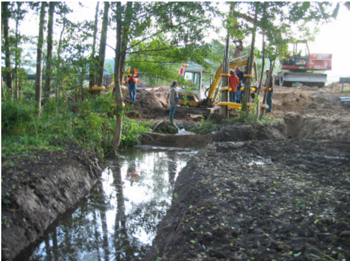
Foto 2: Im Hintergrund wird die Baugrube für die Einbringung des Hamco-Rohres vorbereitet. Im Vordergrund befindet sich der neu geschaffenen Wasserlauf zum Ratzeburger See
