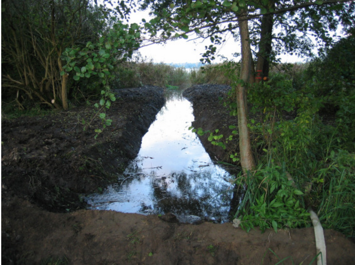
Foto 3: Nach der Entfernung von zwei jeweils 26m langen Betonrohren entstand wieder ein offener Grabenauslauf in die Uferzone des Ratzeburger Sees
